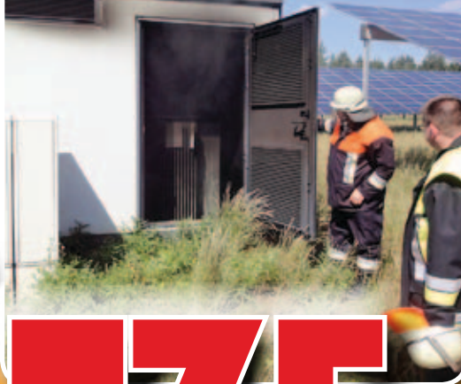
Brand im Solarpark Fiegenstall.
